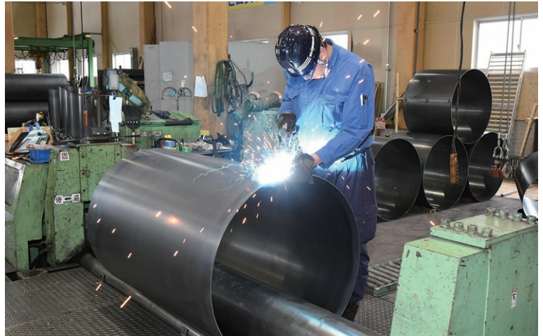
ロール巻加工を終え、仮溶接作業 Tack welding after completion of roll forming
